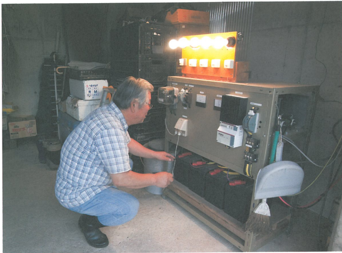
地元のNPO理事長の久保田政則さん。試行錯誤しながら、小水力発電の電気制御を手づくりで行なっている
