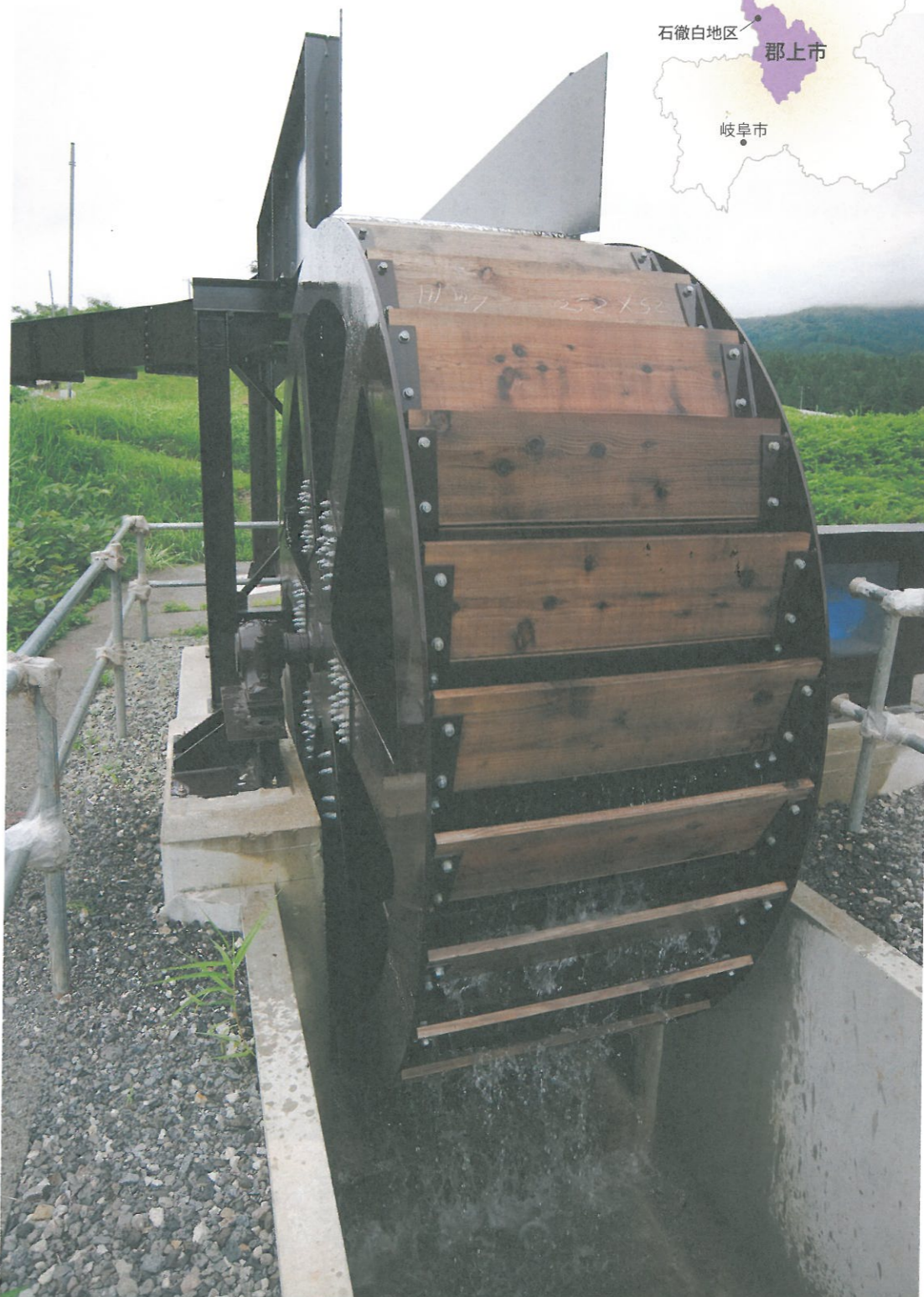
直径3m幅1mの上掛け水車。羽根は地元の杉材を使っており、壊れても交換が可能。農業用水路から水を引き込むバイパス水路に設置した
