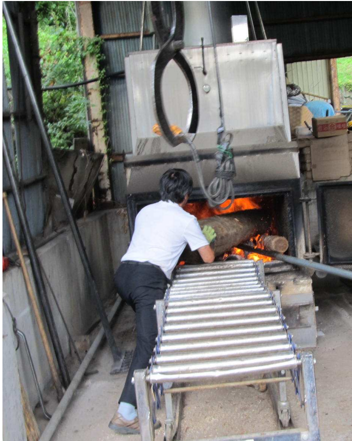
図-9 小諸市の菱野温泉常磐館に導入された薪ボイラー
