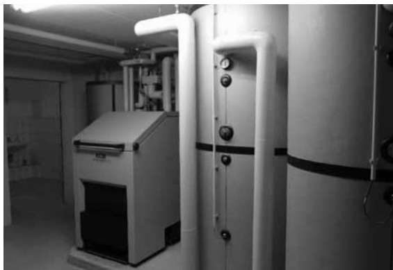
蓄熱タンクと薪ボイラー。このセットが重要
